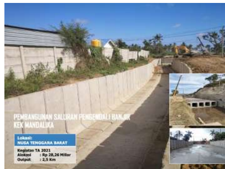
Gambar 20. Pengendali Banjir KEK Mandalika
