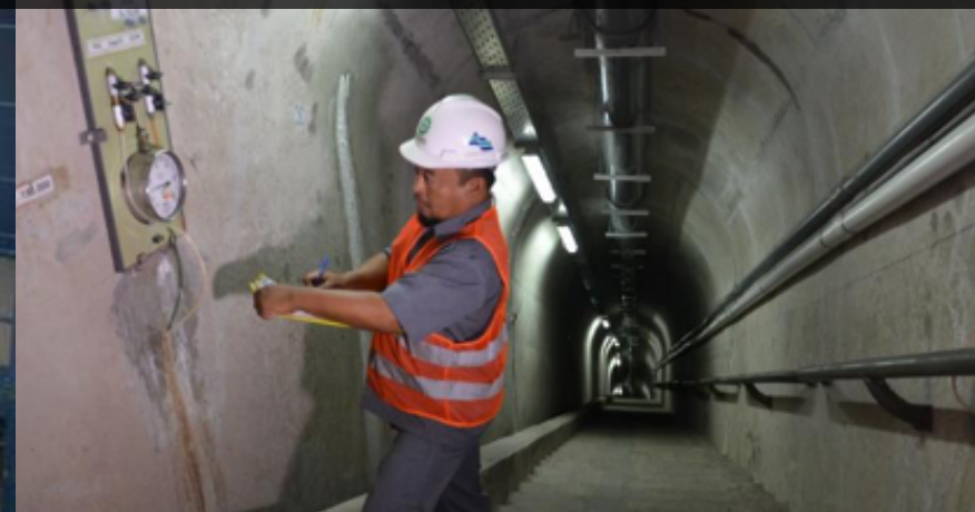
Pemantauan Keamanan Infrastruktur
